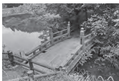
撮影ポイントも撮宝珠のついた欄干は壊れたまま
