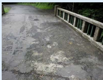
舗装の異常 コンクリート舗装に劣化が みられる状態
