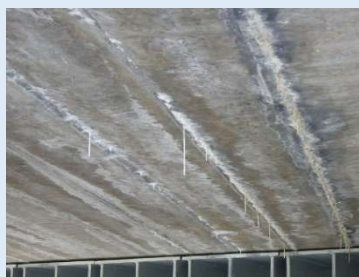
遊離石灰 間詰めコンクリート部から石灰分が つらら状に滲出している状態
