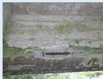
鉄筋露出 コンクリートが剥離し 鉄筋が見えている状態
