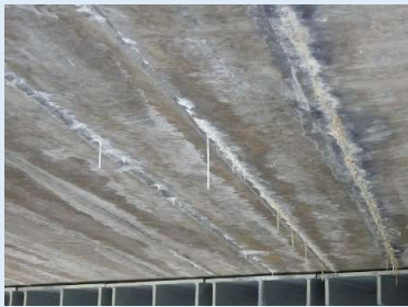
遊離石灰 間詰めコンクリート部から石灰分 がつらら状に滲出している状態
