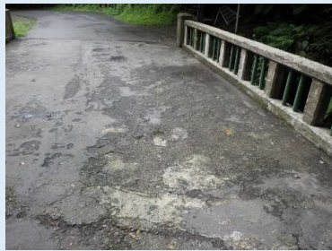
舗装の異常 コンクリート舗装に劣化が みられる状態
