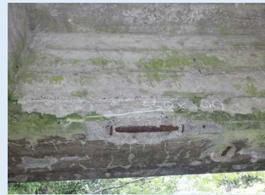
鉄筋露出 コンクリートが剥離し 鉄筋が見えている状態
