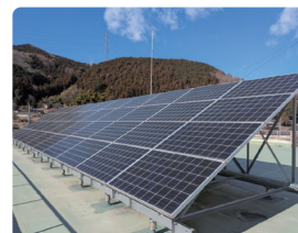
役場に設置された太陽光パネル
