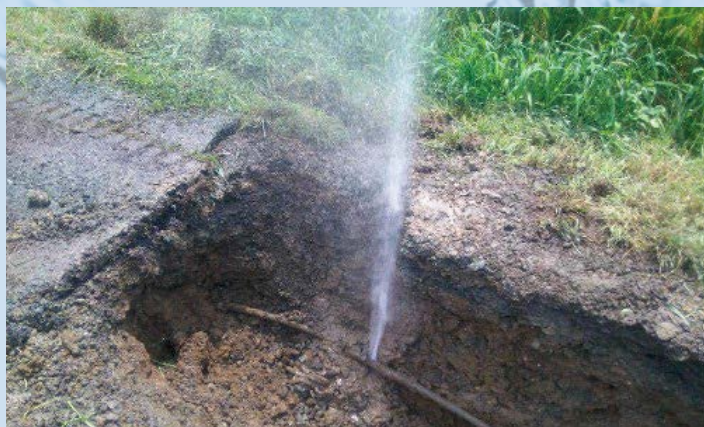
水道管から漏水している状況
