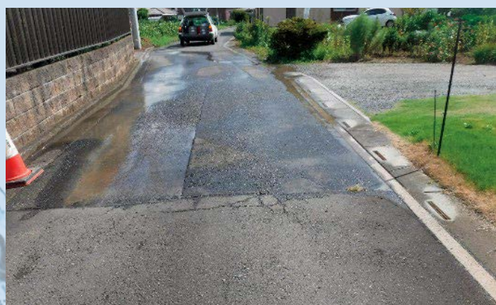
道路上から湧き出ている状況
