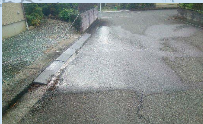
道路上から湧き出ている状況
