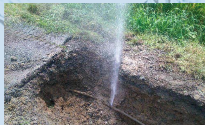
水道管から漏水している状況
