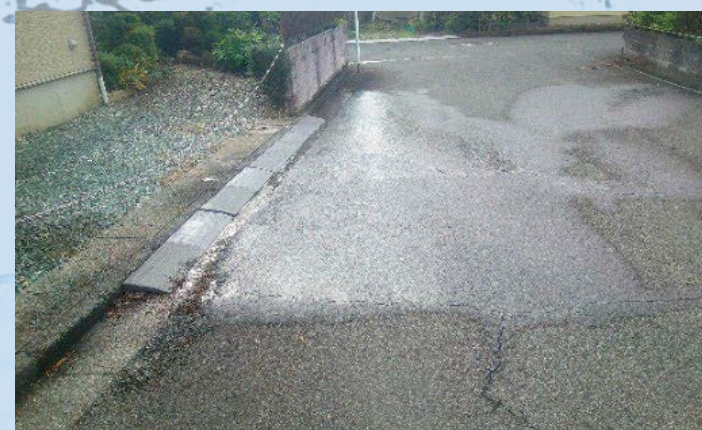
道路上から湧き出ている状況
