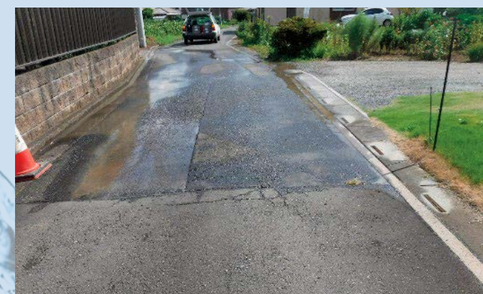
道路上から湧き出ている状況
