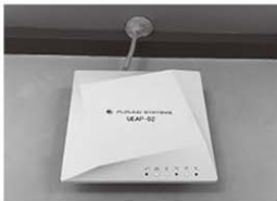
▶3校の校舎内に 設置された無線 LAN
