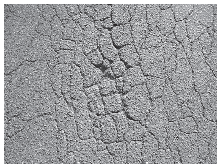
舗装のひび割れ
