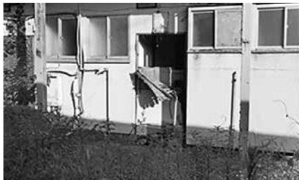
玄関ドアが破損している空き家
