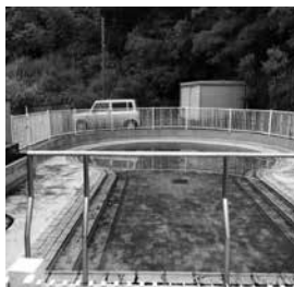
老朽化した越生保育園プール
