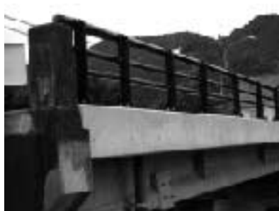
危険な春日橋の欄干
