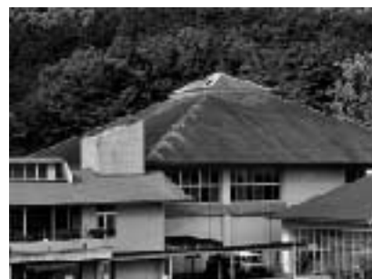
劣化が激しい体育館の屋根
