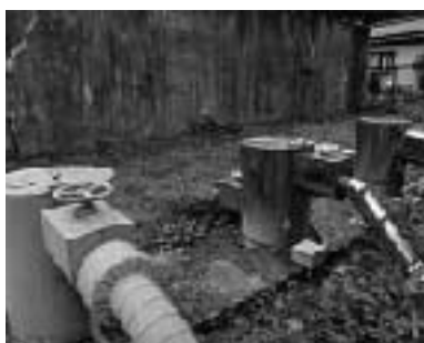
大満・黒山地区への送水ポンプ
