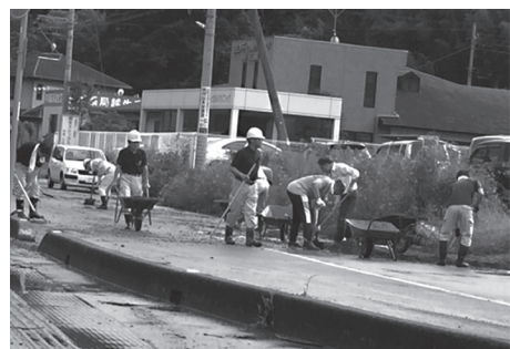
大雨で流出した土砂を片付ける役場職員
