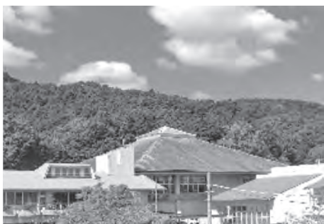
劣化が進む体育館屋根
