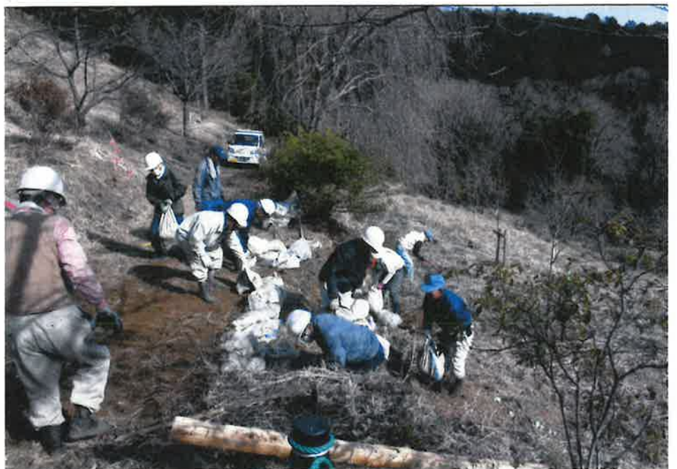
写真6 台風19号被害対応一② 園内通路端亀裂改修
